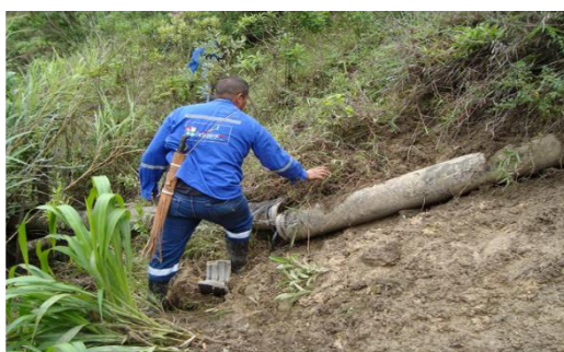
EMERGENCIA EN ACUEDUCTO URBANO DE CAQUEZA, POR FUERTES LLUVIAS
